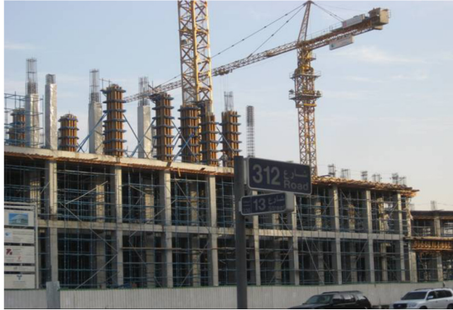
Рис. 1. Возведение здания высотой 20 этажей в г. Дубай с применением традиционных систем опалубки
